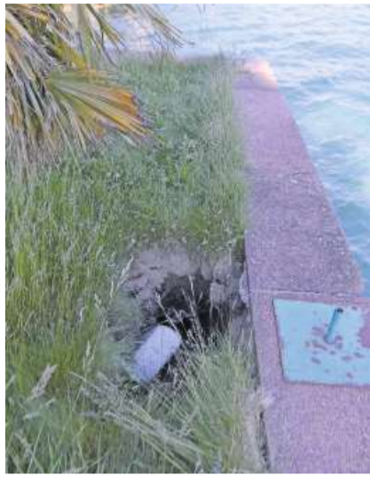
Gleich hinter der Ufermauer ist die Erde abgesenkt. Es klappt ein Loch.
